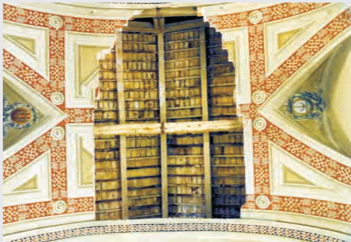
Foto prima dell'intervento
