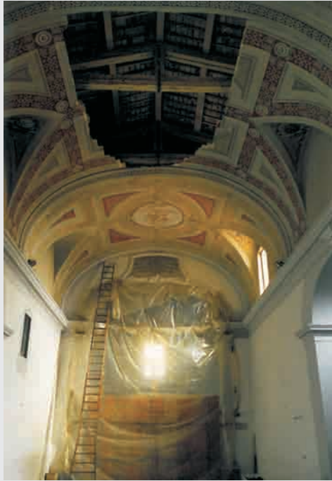
Foto prima dell'intervento
